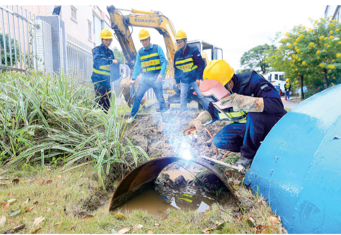
模拟拟维修小组迅速拟定施工维修方案并组织人员开展抢修工作。/佛山市新闻传媒中心记者陈炳辉摄
