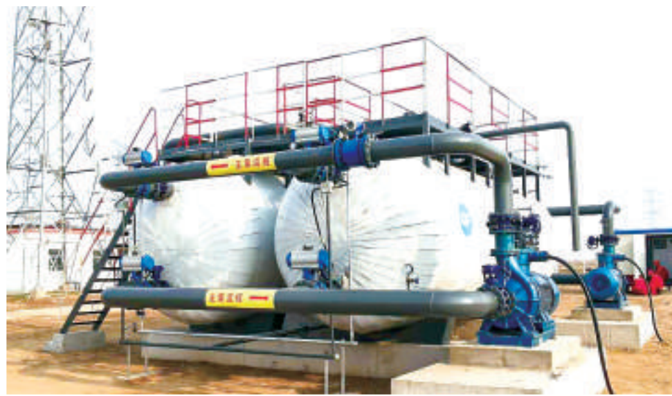
由东方麦田参与设计的“管辅混输装置”已于胜利油田试点应用。/东方麦田供图
